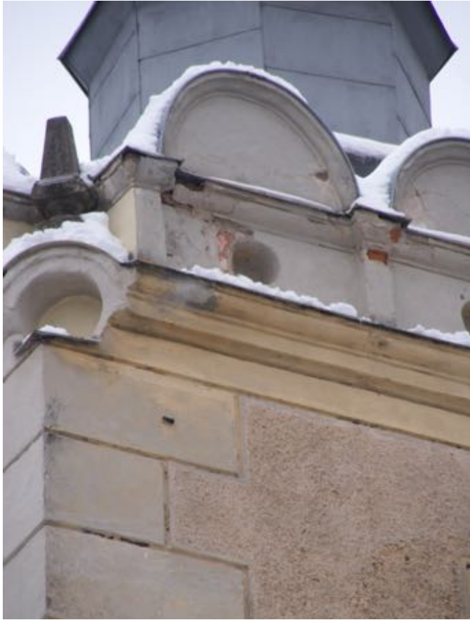
Fot. 21. Kościół pw. św. Jadwigi Śląskiej w Karpnikach. Elewacja wschodnia wieży kościoła, narożnik renesansowej attyki, widoczne ubytki tynku. Fot. Styczeń 2023 r.
