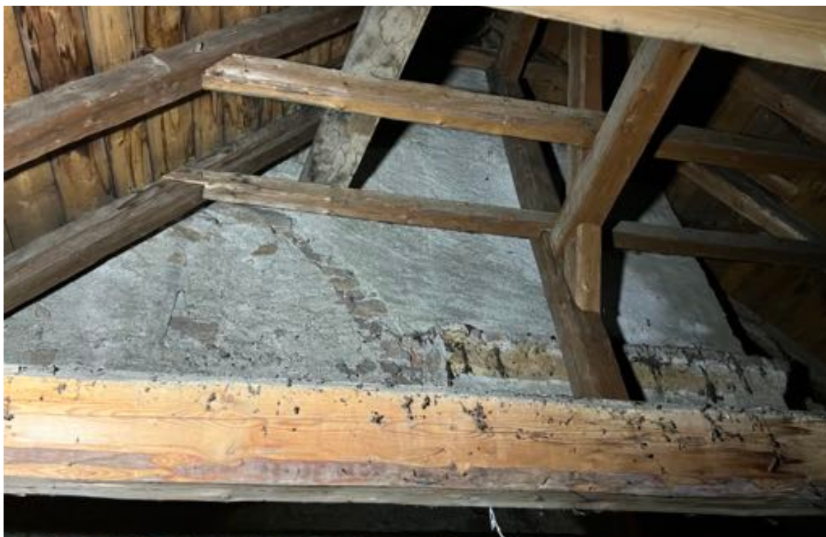
Fot. 28. Kościół pw. św. Jadwigi Śląskiej w Karpnikach. Poddasze nad nawą kościoła, ślady pierwotnego szczytu zachodniego na ścianie wschodniej wieży, pomiędzy jętkami więźby dachowej widoczny fragment pierwotnie eksponowanego na elewacji gzymsu wieży. Fot. Styczeń 2023 r.
