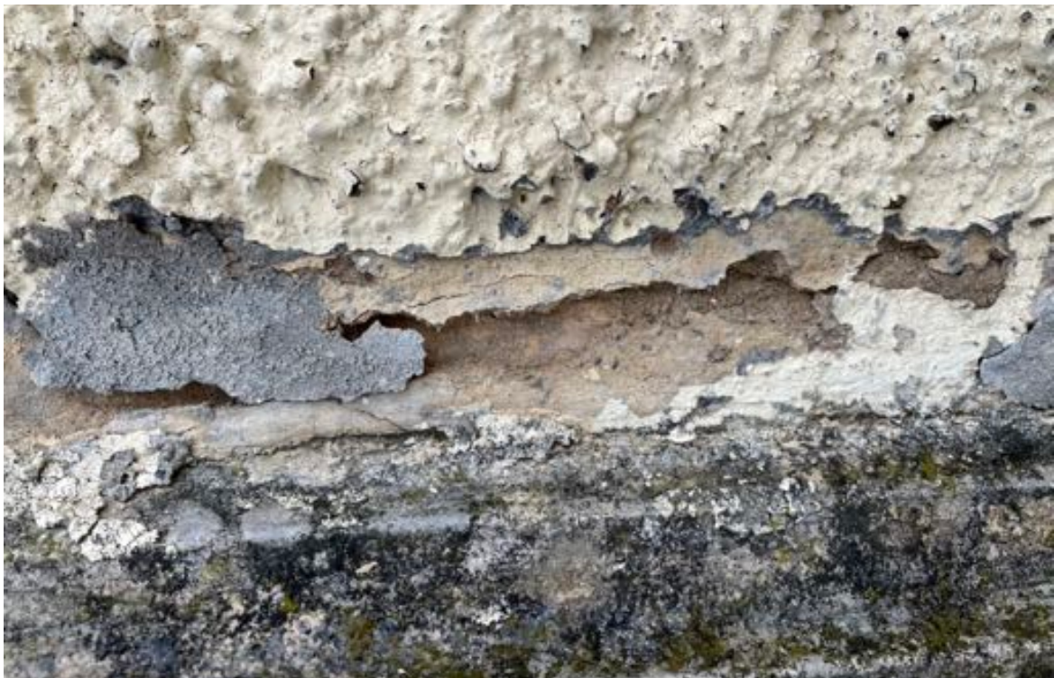
Fot. 18. Kościół pw. św. Jadwigi Śląskiej w Karpnikach. Elewacja południowa, ubytki tynku elewacji na styku z cokołem wieży, widoczne porażone biologiczne fragmenty tynku cokołu, pod warstwą odspojonego tynku cementowo-wapiennego widoczne starsze warstwy tynkarskie elewacji. Fot. Styczeń 2023 r.
