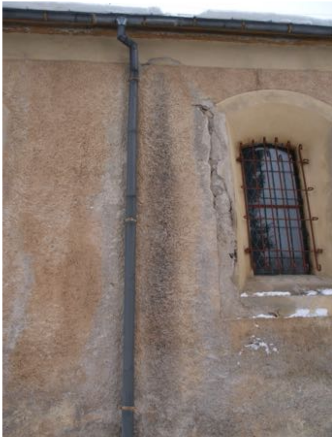
Fot. 37. Kościół pw. św. Jadwigi Śląskiej w Karpnikach. Elewacja południowa, widoczne ubytki, odspojenia i zabrudzenia tynków przy rurze spustowej i otworze okiennym nawy kościoła. Fot. Styczeń 2023 r.
