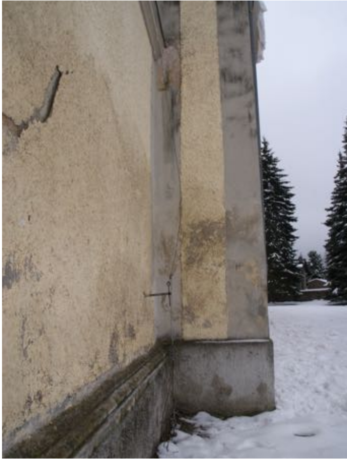
Fot. 35. Kościół pw. św. Jadwigi Śląskiej w Karpnikach. Elewacja południowa w części zachodniej na styku z wieżą, widoczne odspojone tynki oraz zabrudzenia i ślady porażenia biologicznego tynków na cokole. Fot. Styczeń 2023 r.
