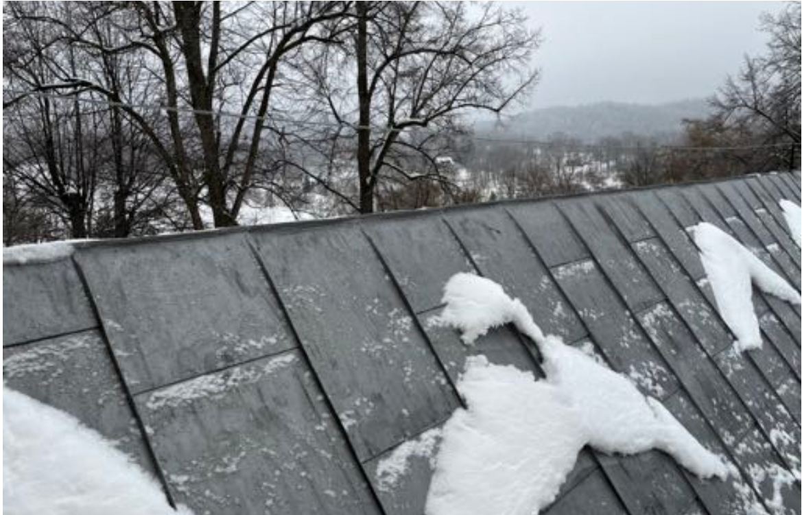
Fot. 49. Kościół pw. św. Jadwigi Śląskiej w Karpnikach. Kalenica dachu nad nawą kościoła, istniejące pokrycie dachowe z blachy płaskiej cynkowej układanej na rąbek stojący, łączenia blachy w poziomie na rąbek leżący zapewniający spływ wód opadowych. Fot. Styczeń 2023 r.
