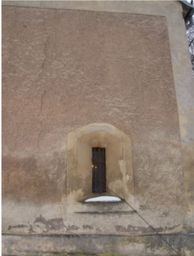
Fot. 41. Kościół pw. św. Jadwigi Śląskiej w Karpnikach. Elewacja wschodnia w części północnej, okno zakrystii, widoczne pęknięcie na całej wysokości elewacji (w osi ściany dzielącej prezbiterium i zakrystię) oraz zawilgocenia tynku powyżej cokołu i ślady porażenia biologicznego (zielony nalot). Fot. Styczeń 2023 r.
