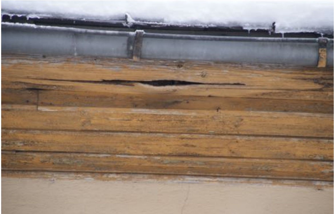
Fot. 43. Kościół pw. św. Jadwigi Śląskiej w Karpnikach. Dach nad prezbiterium, widoczne zniszczenia drewna podbitki. Fot. Styczeń 2023 r.
