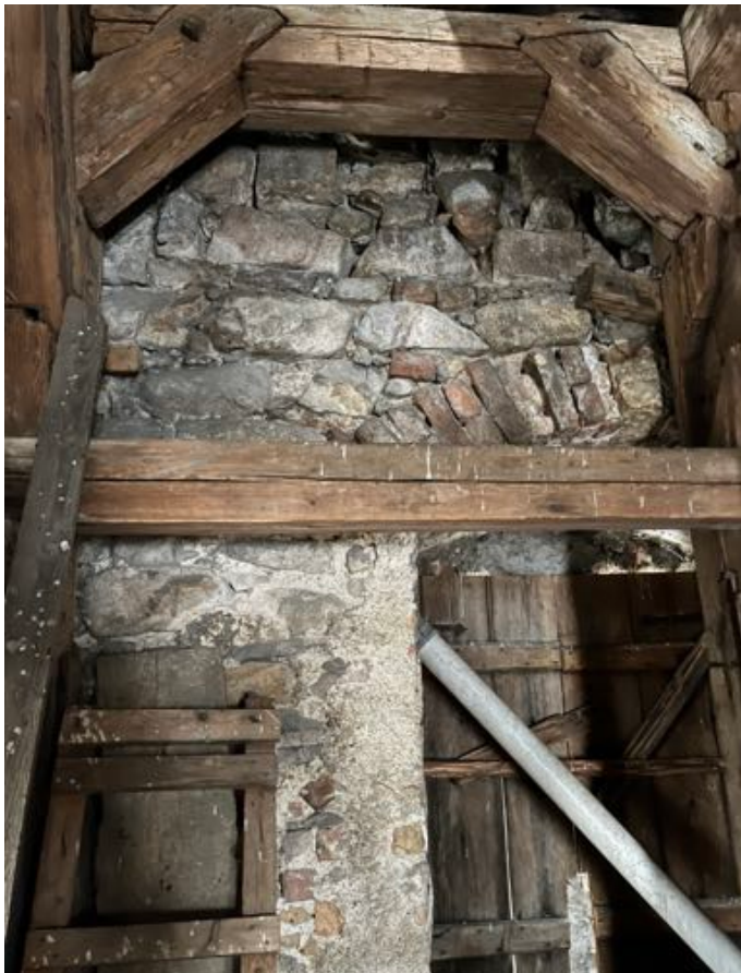
Fot. 62. Kościół pw. św. Jadwigi Śląskiej w Karpnikach. Wnętrze wieży, widoczna konstrukcja kamiennego mur, fragmenty wewnętrznej konstrukcji
