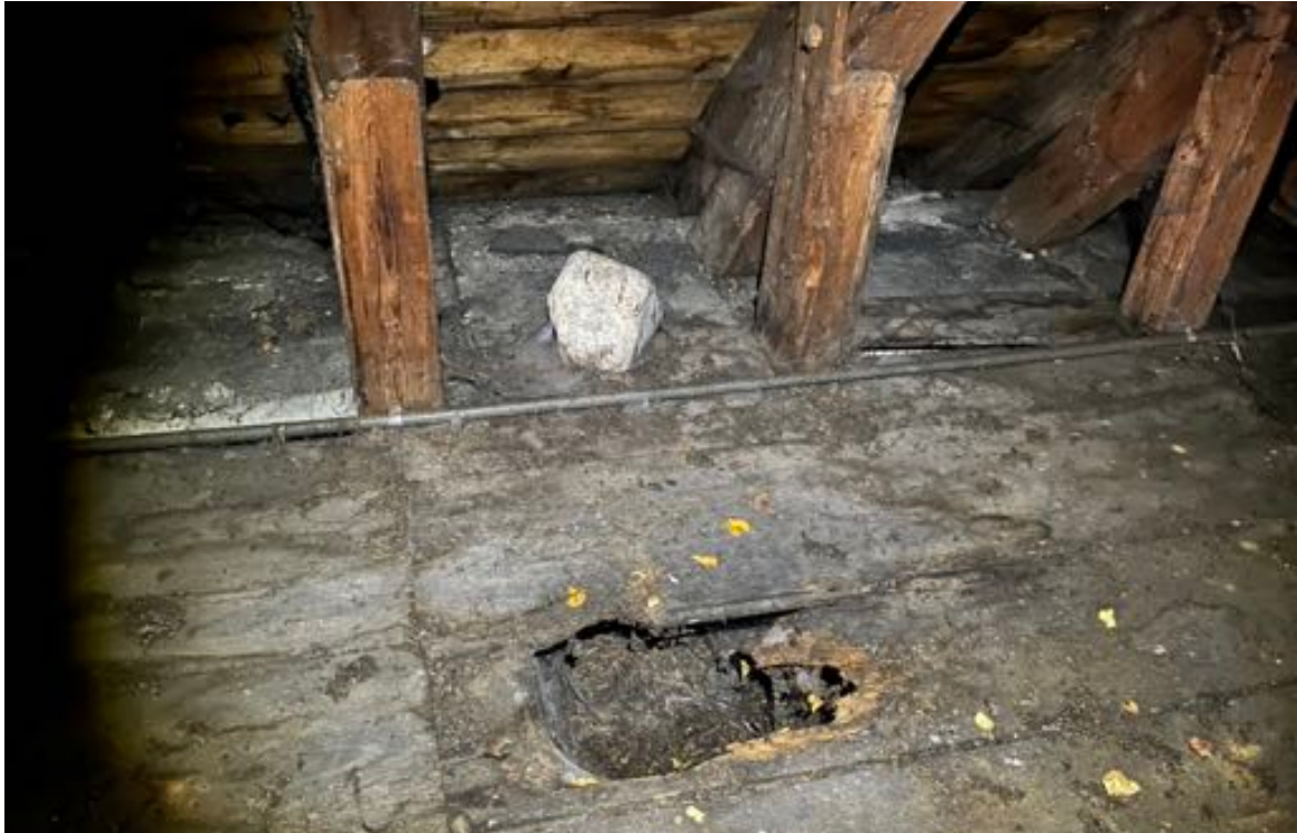
Fot. 59. Kościół pw. św. Jadwigi Śląskiej w Karpnikach. Podłoga drewniana na poddaszu (dolna kondygnacja więźby dachowej) z widocznymi zniszczeniami, śladami wcześniejszego zawilgocenia i ubytkami. Fot. Styczeń 2023 r.
