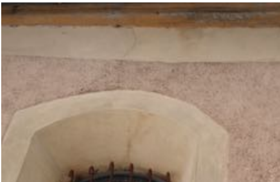
Fot. 34. Kościół pw. św. Jadwigi Śląskiej w Karpnikach. Fragment elewacji południowa w części zachodniej, pierwszy od strony wieży otwór okienny, widoczne pęknięcie na osi okna. Fot. Styczeń 2023 r.
