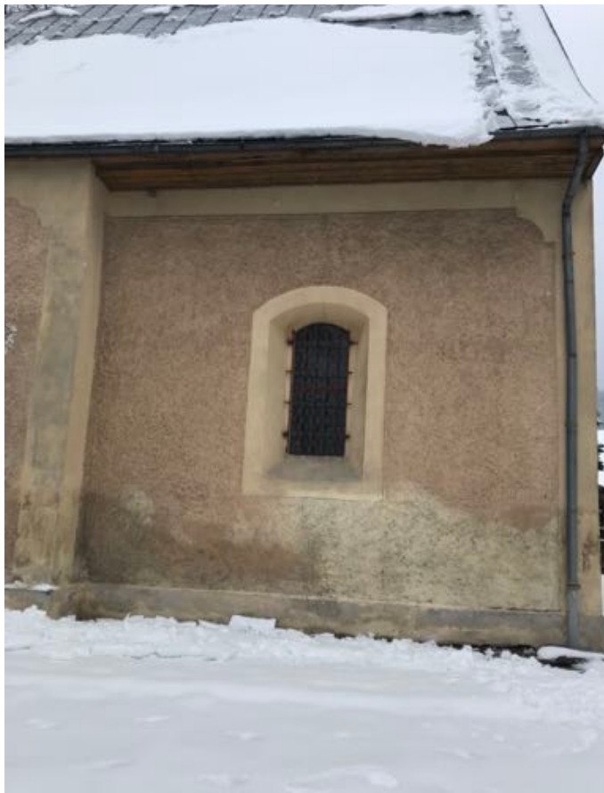
Fot. 38. Kościół pw. św. Jadwigi Śląskiej w Karpnikach. Elewacja południowa prezbiterium, widoczne zawilgocenia tynków i wtórne uzupełnienia oraz przemalowania powyżej cokołu. Fot. Styczeń 2023 r.
