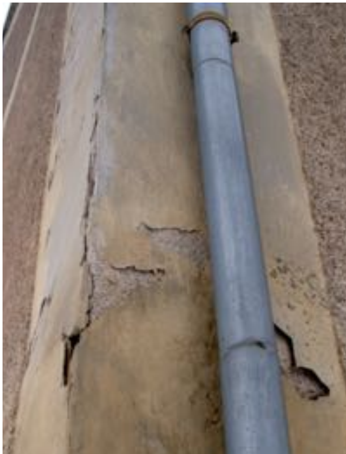
Fot. 40. Kościół pw. św. Jadwigi Śląskiej w Karpnikach. Północno-wschodni narożnik budynku, odspojone tynki przy rurze spustowej. Fot. Styczeń 2023 r.
