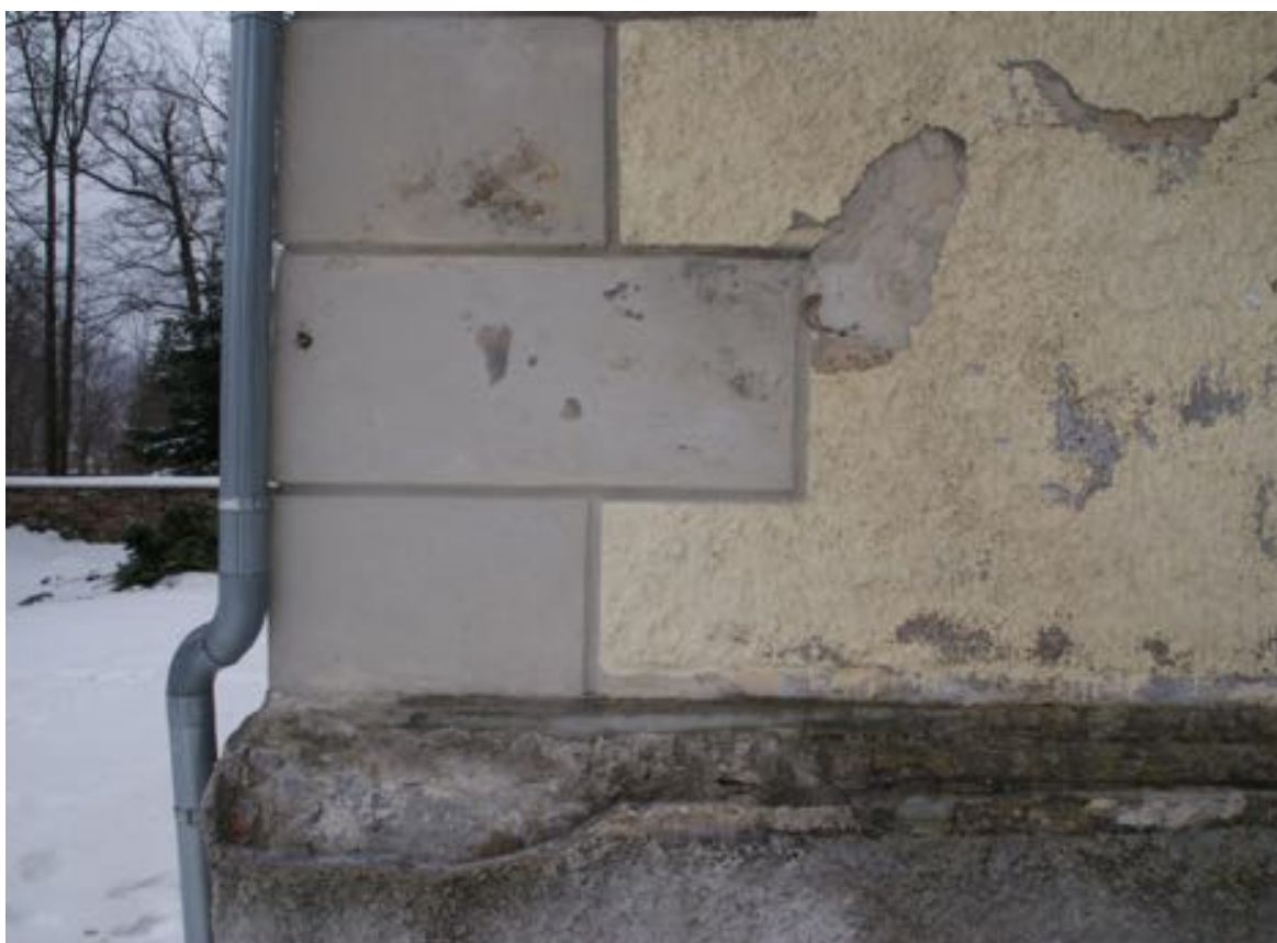
Fot. 16. Kościół pw. św. Jadwigi Śląskiej w Karpnikach. Elewacja południowa, cokół wieży w południowo-zachodnim narożniku, widoczne ubytki tynku w cokole i na elewacji powyżej, czytelne zawilgocone i porażone biologiczne fragmenty tynku. Fot. Styczeń 2023 r.
