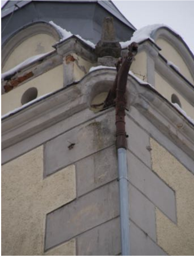
Fot. 23. Kościół pw. św. Jadwigi Śląskiej w Karpnikach. Południowo-zachodni narożnik wieży na poziomie attyki, narożny metalowy rzygacz z widoczną korozją (rdza), widoczne także ubytki tynku attyki i odsłonięte fragmenty cegieł ceramicznych. Fot. Styczeń 2023 r.
