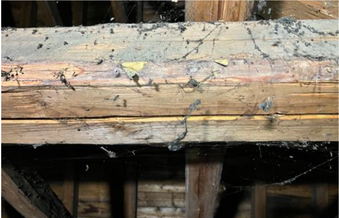
Fot. 57. Kościół pw. św. Jadwigi Śląskiej w Karpnikach. Więźba dachowa, detal obróbki drewna, fragment nieoflisowanej belki konstrukcyjnej. Fot. Styczeń 2023 r.
