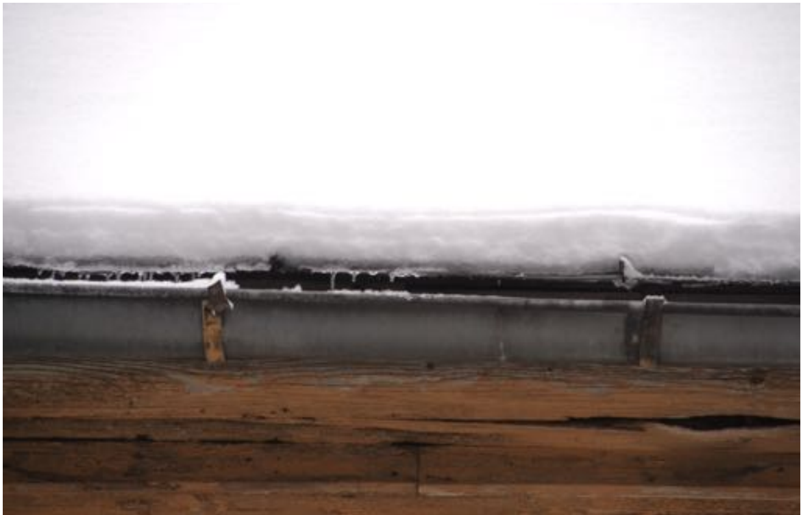
Fot. 44. Kościół pw. św. Jadwigi Śląskiej w Karpnikach. Dach nad nawą, widoczne mocowania rylnien do powiększenia oraz zniszczenia drewna podbitki. Fot. Styczeń 2023 r.
