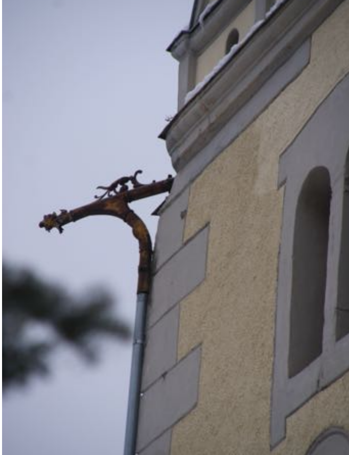
Fot. 24. Kościół pw. św. Jadwigi Śląskiej w Karpnikach. Południowa elewacja wieży, narożny metalowy rzygacz z widoczną korozją (rdza). Fot. Styczeń 2023 r.
