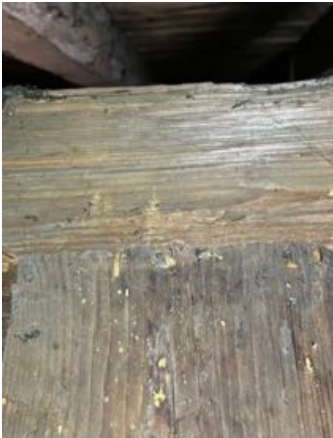
Fot. 60. Kościół pw. św. Jadwigi Śląskiej w Karpnikach. Więźba dachowa, ślady żerowania kołatka na elementach konstrukcyjnych więźby. Fot. Styczeń 2023 r.
