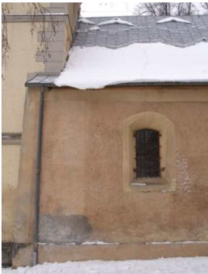
Fot. 33. Kościół pw. św. Jadwigi Śląskiej w Karpnikach. Elewacja południowa w części zachodniej, pierwszy od strony wieży otwór okienny, widoczne pęknięcie na osi okna oraz wtórne uzupełnienia tynku elewacji powyżej cokołu zaprawą cementową. Fot. Styczeń 2023 r.
