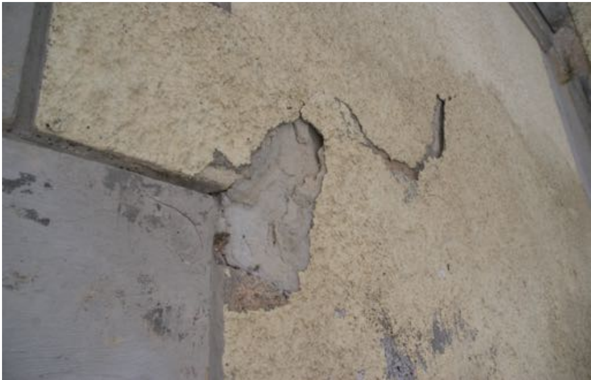
Fot. 19. Kościół pw. św. Jadwigi Śląskiej w Karpnikach. Elewacja południowa, widoczne odspojenie oraz ubytki tynku cementowo-wapiennego na elewacji, na styku z narożnym boniowaniem oraz wtórne uzupełnienia zaprawą cementową. Fot. Styczeń 2023 r.
