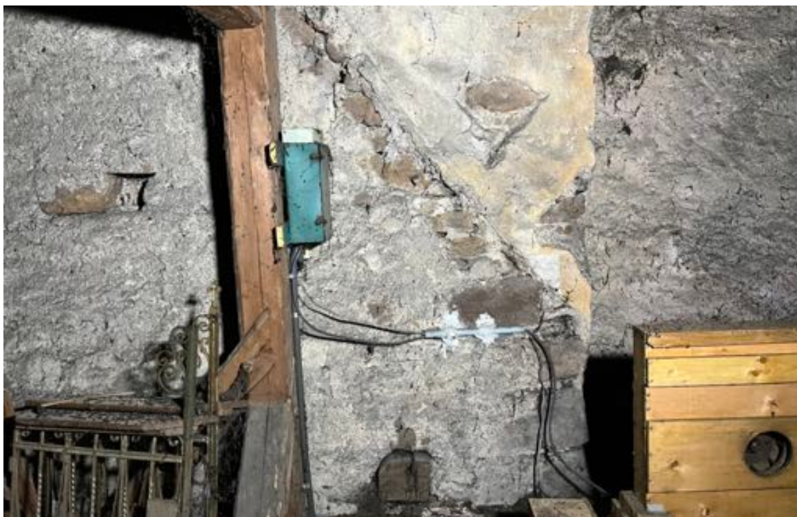
Fot. 27. Kościół pw. św. Jadwigi Śląskiej w Karpnikach. Poddasze nad nawą kościoła, ślady pierwotnego szczytu zachodniego na ścianie wschodniej wieży, widoczne pozostałości pierwotnej warstwy tynkarskiej i kolorystycznej elewacji wschodniej wieży. Fot. Styczeń 2023 r.
