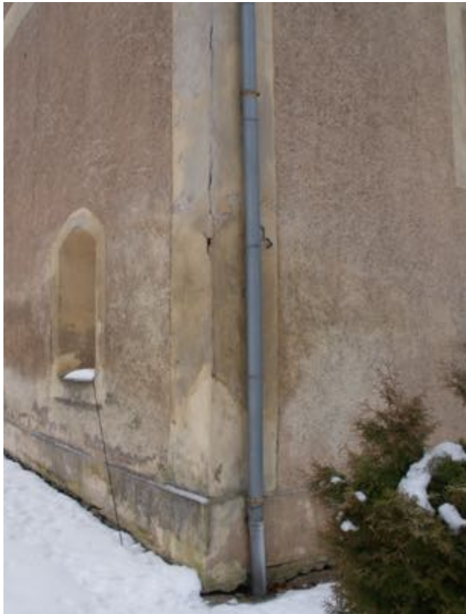
Fot. 39. Kościół pw. św. Jadwigi Śląskiej w Karpnikach. Północno-wschodni narożnik budynku, widoczne odspojenia i zawilgocenia tynku przy rurze spustowej. Fot. Styczeń 2023 r.
