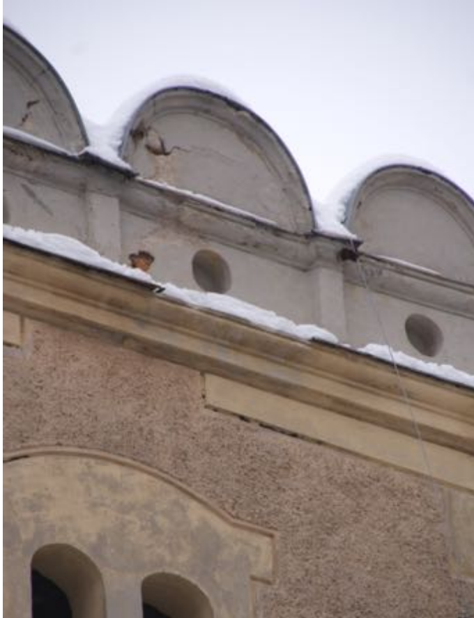
Fot. 22. Kościół pw. św. Jadwigi Śląskiej w Karpnikach. Renesansowa attyka wieży, widoczne ubytki i spękania warstw tynku. Fot. Styczeń 2023 r.
