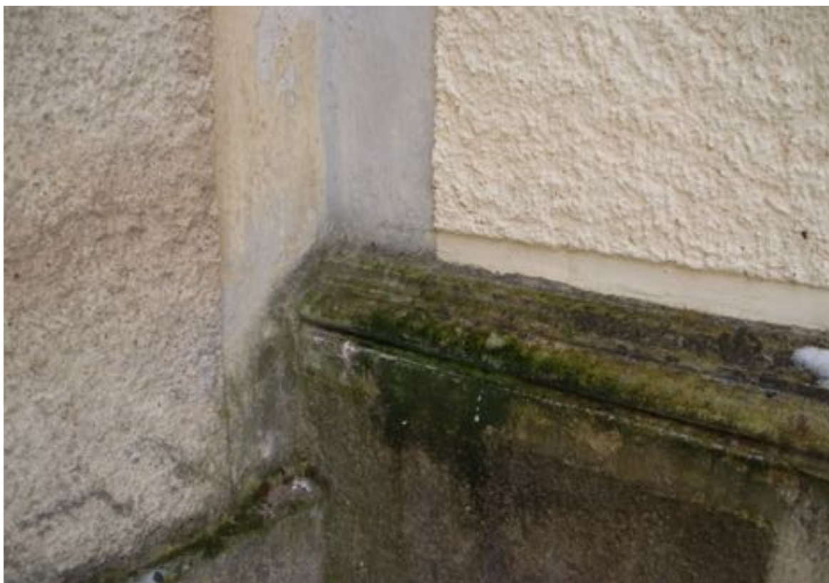
Fot. 15. Kościół pw. św. Jadwigi Śląskiej w Karpnikach. Elewacja północna, cokół wieży w miejscu styku ze ścianą korpusu kościoła, widoczne zawilgocenie i porażenie biologiczne tynku (ciemne plamy i zielony nalot). Fot. Styczeń 2023 r.
