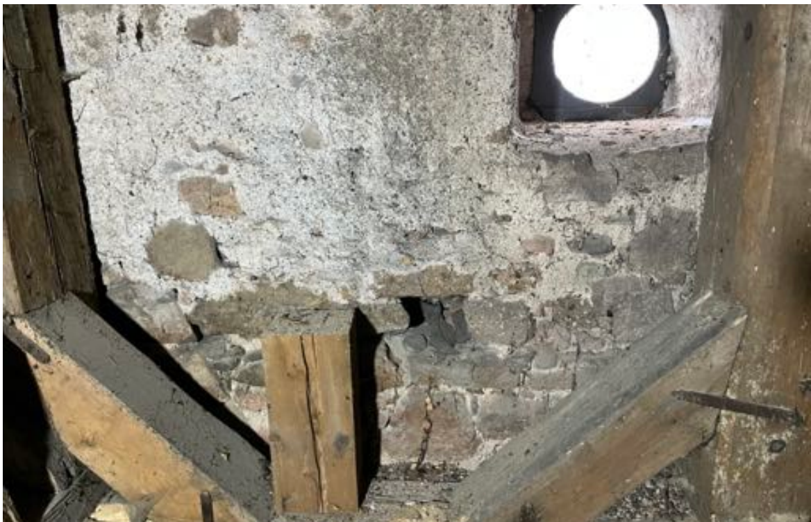
Fot. 64. Kościół pw. św. Jadwigi Śląskiej w Karpnikach. Wnętrze wieży, widoczna konstrukcja kamiennego mur, fragmenty wewnętrznej konstrukcji dzwonnicy z belek drewnianych oraz okrągły otwór okienny w attyce. Fot. Styczeń 2023 r.
