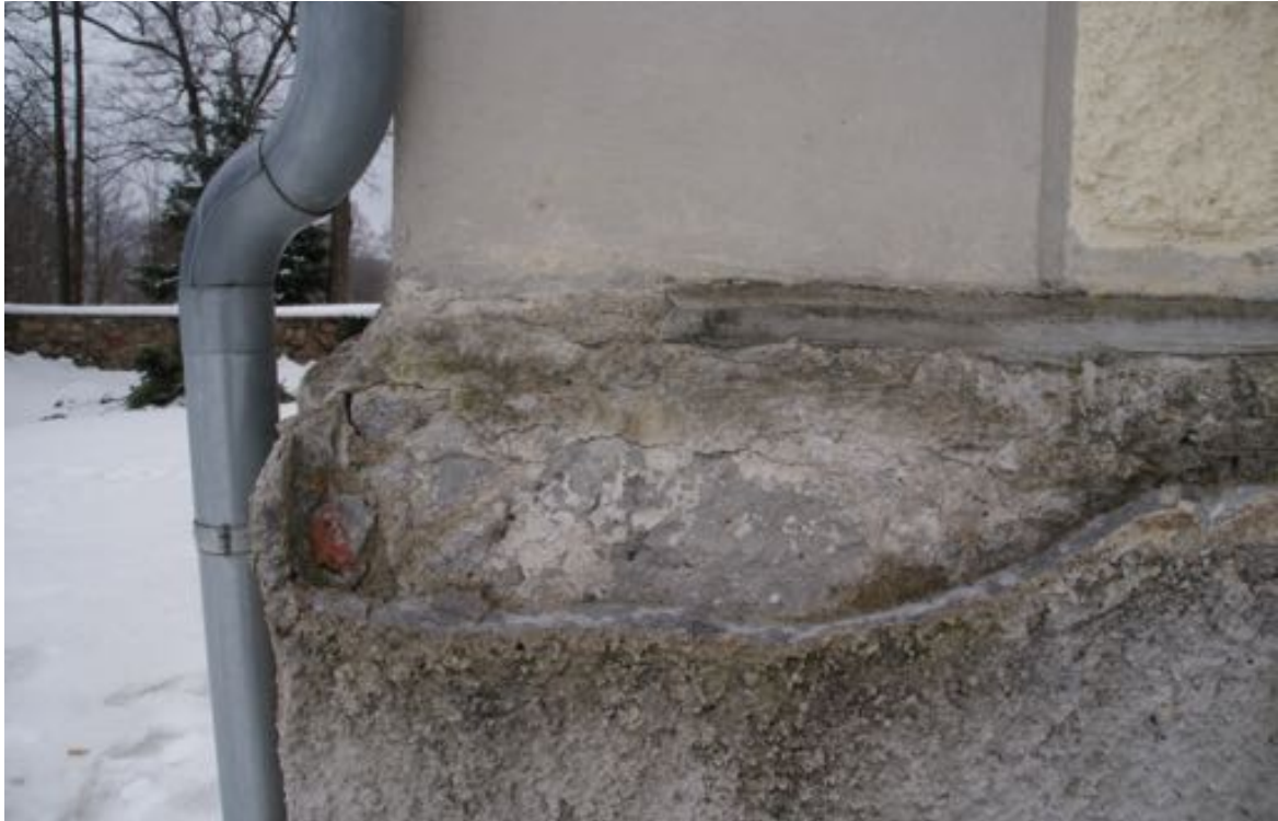
Fot. 17. Kościół pw. św. Jadwigi Śląskiej w Karpnikach. Elewacja południowa, cokół wieży w południowo-zachodnim narożniku, widoczny znaczący ubytek tynku w cokole oraz ślady porażenia biologicznego tynku. Pod warstwą odspojonego tynku cementowo-wapiennego widoczne starsze warstwy tynkarskie oraz kamiennego muru. Fot. Styczeń 2023 r.
