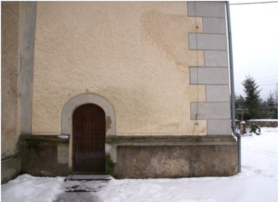
Fot. 14. Kościół pw. św. Jadwigi Śląskiej w Karpnikach. Elewacja północna wieży, drzwi wejściowe oraz cokół z widocznym zawilgoceniem i porażeniem biologicznym tynku (ciemne plamy i zielony nalot). Fot. Styczeń 2023 r.
