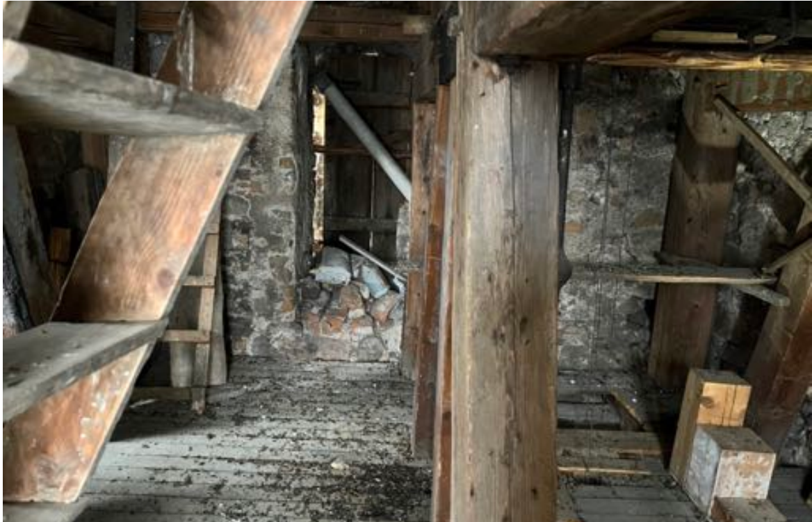
Fot. 63. Kościół pw. św. Jadwigi Śląskiej w Karpnikach. Wnętrze wieży, widoczna konstrukcja kamiennego mur, fragmenty wewnętrznej konstrukcji dzwonnicy z belek drewnianych oraz okiennica zamykająca prostokątne okno w elewacji zachodniej. Z prawej strony widoczna także belka z datą 1897 (data restauracji XIX-wiecznej). Fot. Styczeń 2023 r.
