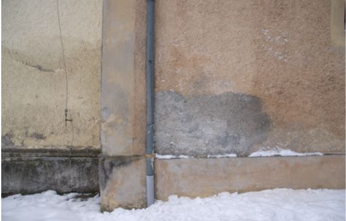
Fot. 36. Kościół pw. św. Jadwigi Śląskiej w Karpnikach. Elewacja południowa w części zachodniej na styku z wieżą, widoczne odspojone tynki na wieży, zabrudzenia i ślady porażenia biologicznego tynków na cokole oraz wtórne uzupełnienia tynku elewacji przy rurze spustowej, powyżej cokolu, zaprawą cementową. Fot. Styczeń 2023 r.
