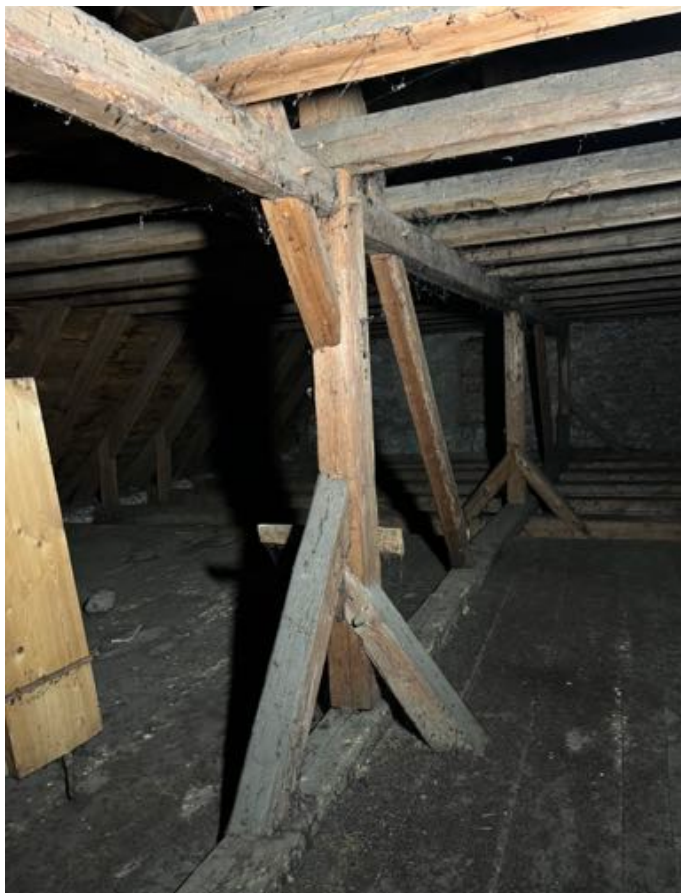
Fot. 58. Kościół pw. św. Jadwigi Śląskiej w Karpnikach. Więźba dachowa, widok w kierunku wschodnim na poziomie pierwszego piętra konstrukcji, widoczna podwalina ramy storczykowej, wraz ze storczykami, mieczami stopowymi storczyków, rygłem usztywnienia wzdłużnego oraz opartymi na nim jętkami. Fot. Styczeń 2023 r.
